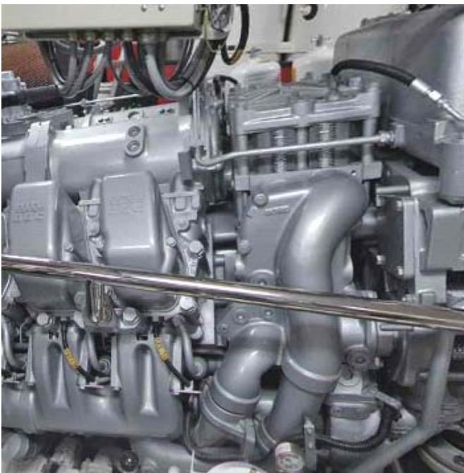
Blick in den Maschinenraum
